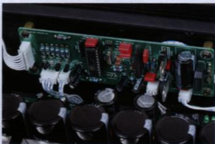
Blok sterujący odsunięto od zaekranowanego zasilacza.
